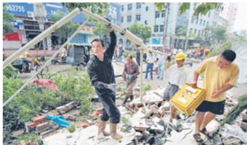
Wiederaufbau nach dem Sturm: In der Stadt Fuding hat der Taifun unter anderem eine elektrische Betriebsanlage zerstört. FOTO: ACTION PRESS
